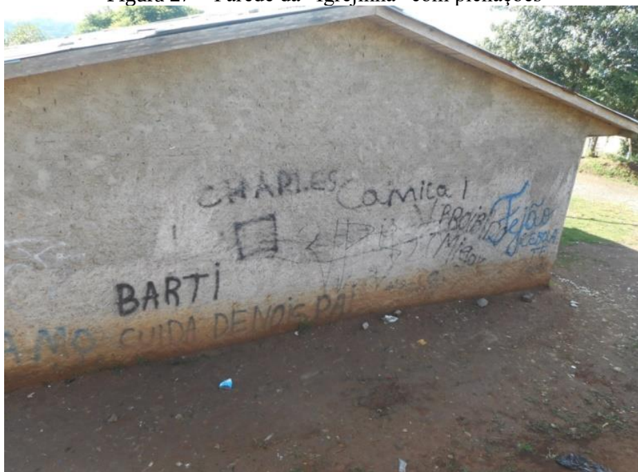
Figura 27 – Parede da “Igrejinha” com pichações
