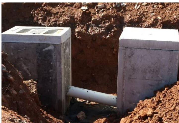
(a) Tubo de PVC ligando boca-de-lobo e chaminé
