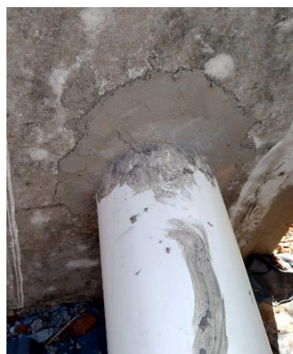
(b) Detalhe da fixação do tubo de PVC nas caixas de concreto
