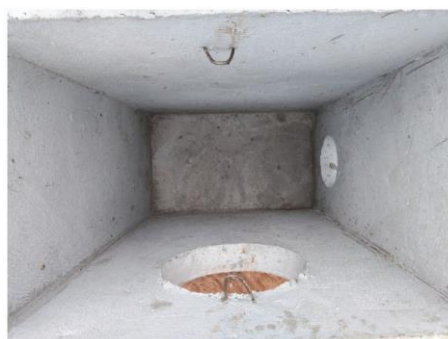
(b) Interior da caixa coletora
