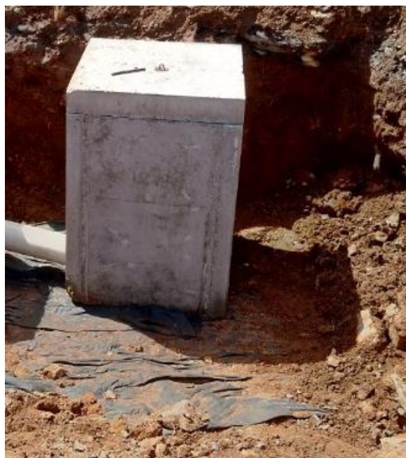
(b) Chaminé de acesso posicionada e tampada no Poço 2
