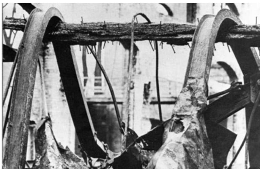
Figura 4 – Vigas de madeira e estruturas metálicas submetidas a um severo incêndio
