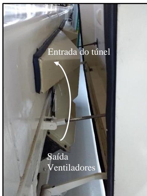
Figura 24 – Sistema de Refrigeração do túnel que produz o biscoito 2
