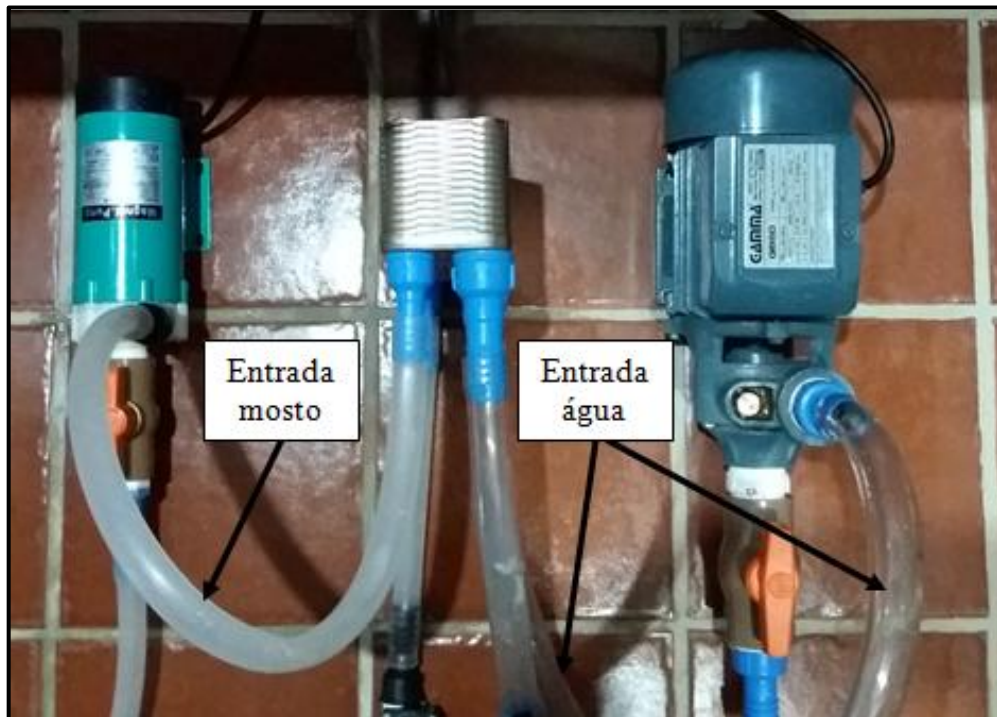
Figura 21 - Bombas utilizadas para movimento dos fluidos
