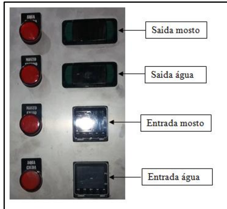
Figura 22 – Painel de medidores
