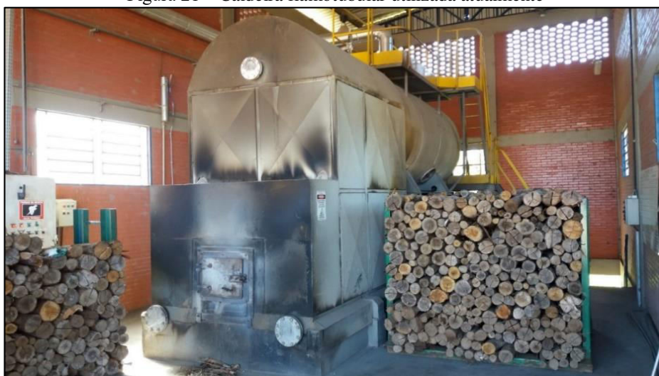
Figura 21 – Caldeira flamotubular utilizada atualmente
