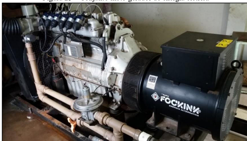
Figura 23 – Conjunto moto gerador de energia elétrica
