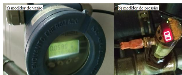
Figura 17 - Medidores instalados na máquina
