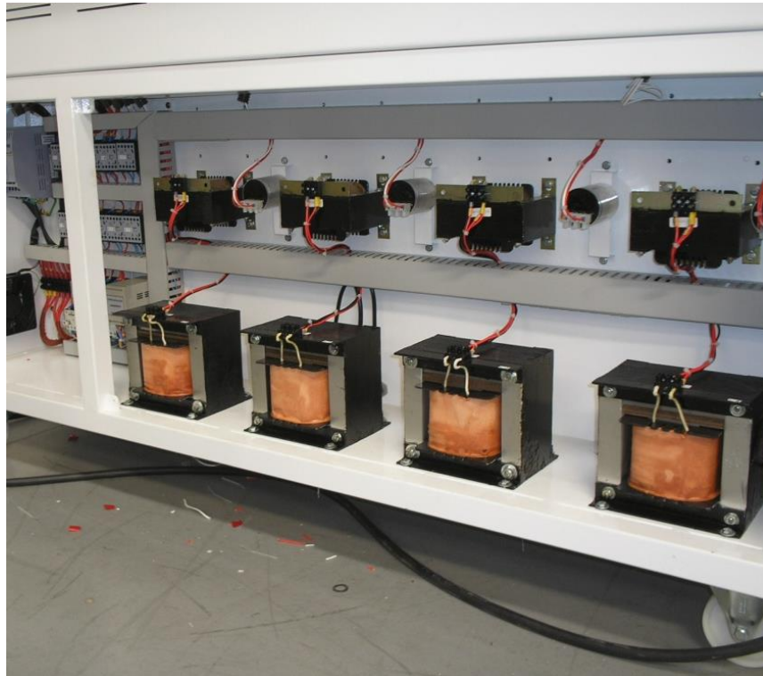
Figura 21-Transformadores usados em um túnel UV
