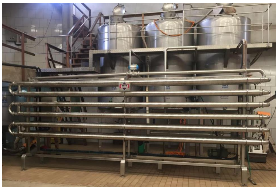
Figura 5 - Sistema tubular trocador de calor Foto: a Autora (2018).
