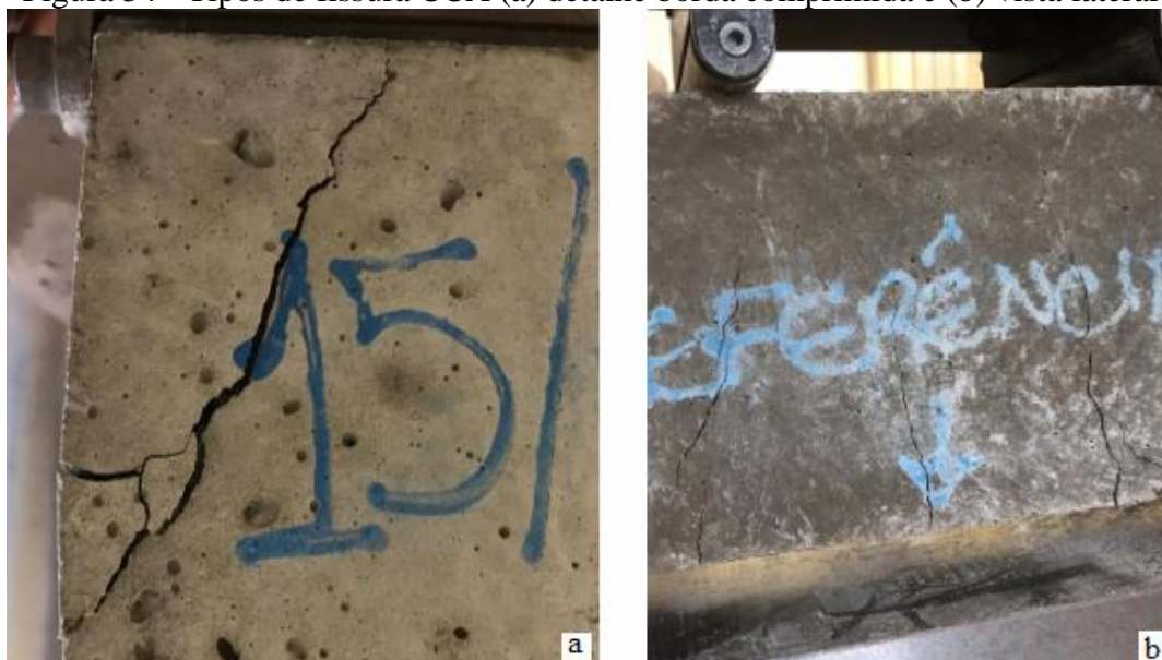
Figura 34 - Tipos de fissura CCA (a) detalhe borda comprimida e (b) vista lateral
