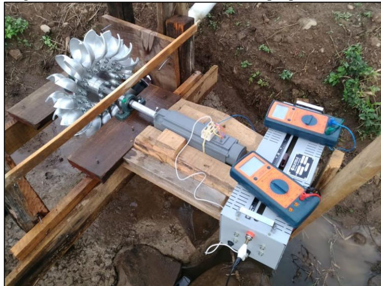
Figura 17 - Turbina Pelton instalada na propriedade rural
