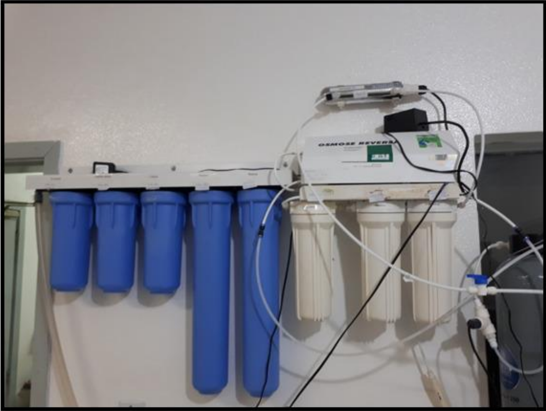
Anexo 1 - Filtros de água.
