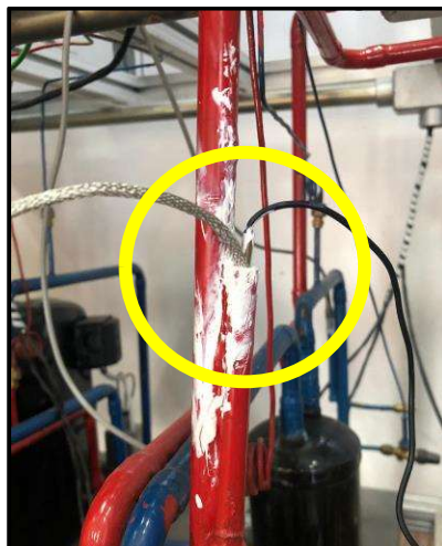
Figura 31 - Medidor de temperatura e Termopar PT100 instalados
