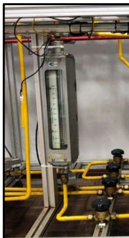
Figura 21 - Medidor de vazão da bancada
