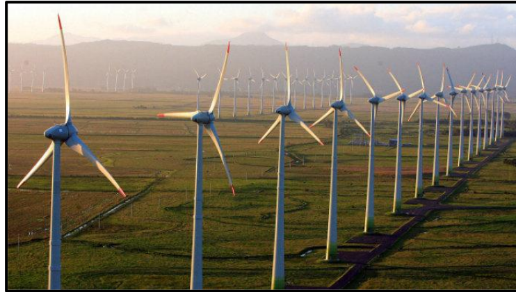
Figura 7 – Turbinas Eólicas de eixo horizontal (TEEH) instalados em Osório/RS
