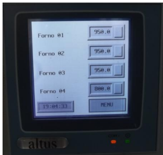
Figura 14: Painel de controle para ajuste de temperaturas.
