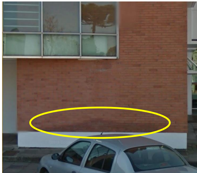
Figura 35 - Manifestação patológica na fachada sul de tijolo aparente do RU
