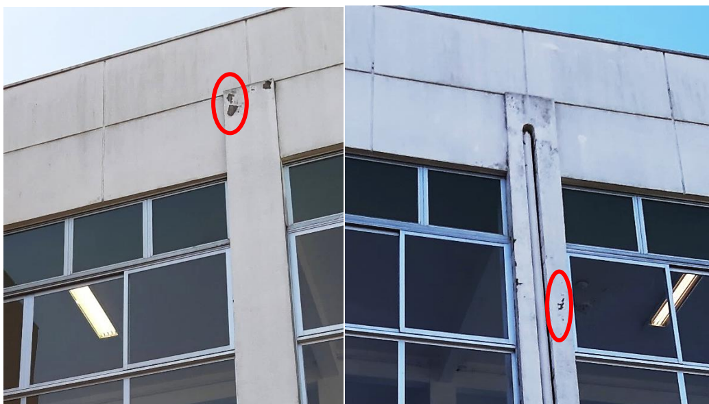
Figura 32 - Manifestações patológicas na fachada sul do Restaurante Universitário: a) destacamento de pintura RUS – ARGB2 b) destacamento de pintura RUS – ARGC2
