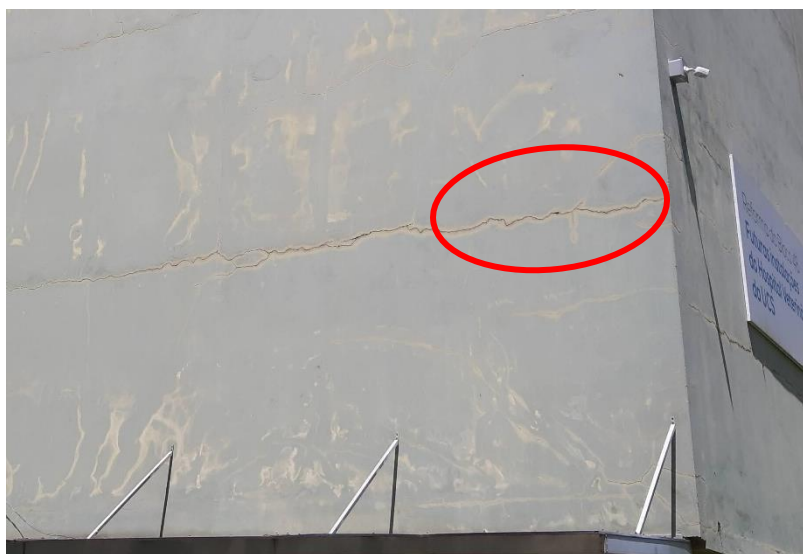
Figura 33 - Manifestação patológica na fachada norte do Bloco 46
