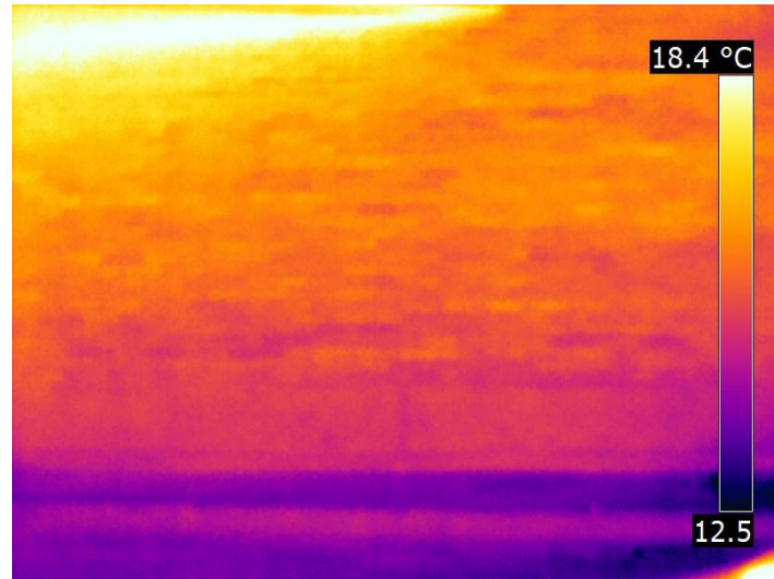
Figura 29 - Termograma com pouca nitidez retirado da fachada de tijolo aparente do RU (sul)
