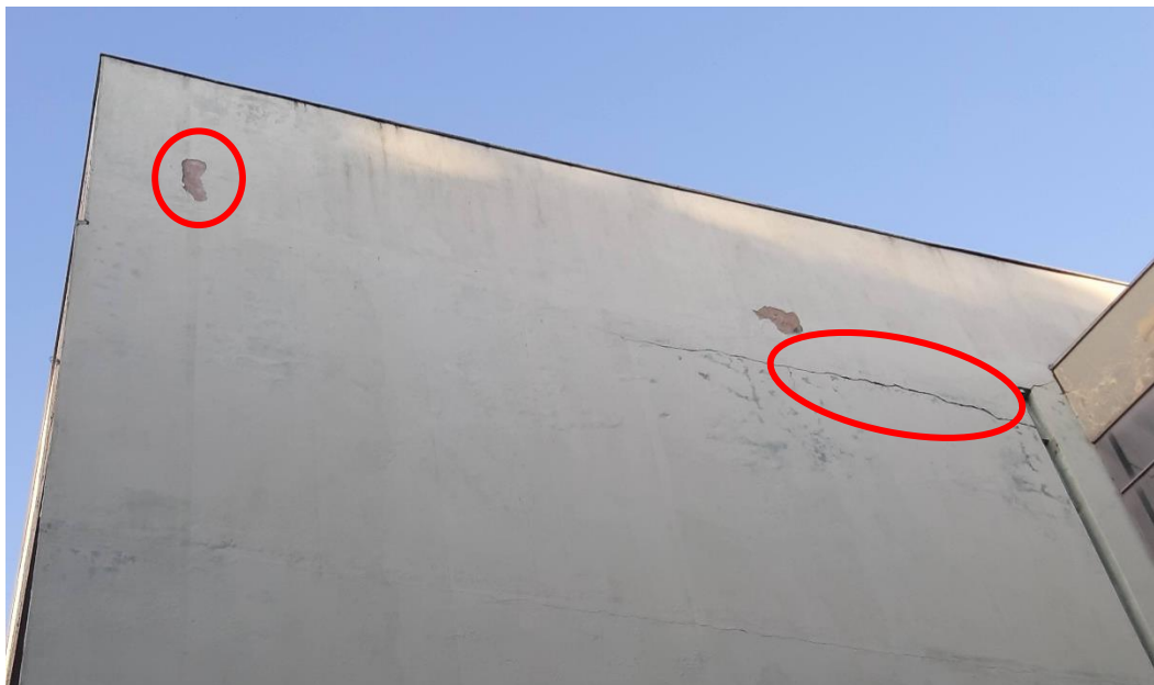
Figura 34 - Manifestações patológicas na Fachada sul do bloco 46
