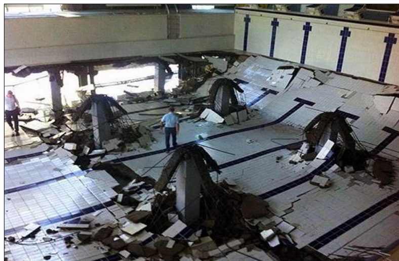
Figura 5 - Colapso Parcial Piscina, em Krasnodar, Rússia em 2013.
