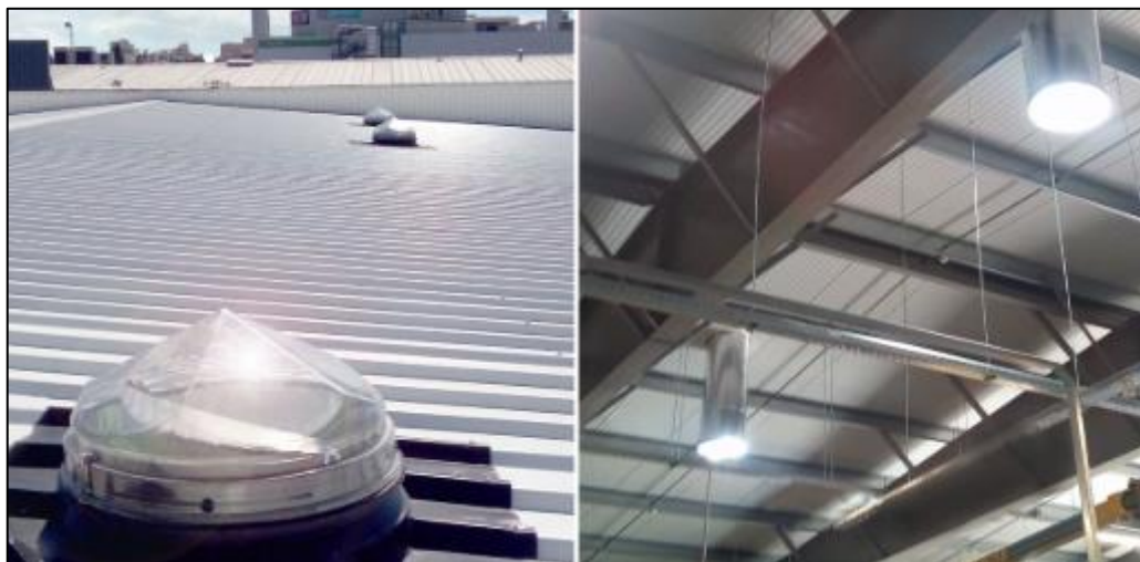
Figura 2 – Iluminação industrial via tubo solar
