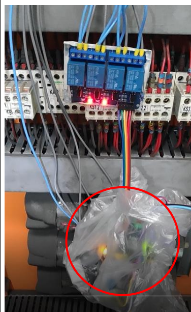
Figura 34 – quadro de comando da Retifica externa RE-1065.
