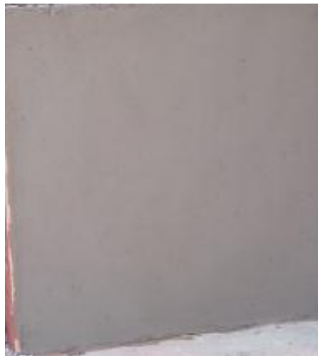
Figura 20: Parede sem fissuração
