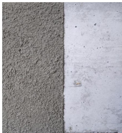
Figura 16: Parede com chapisco na metade de sua face
