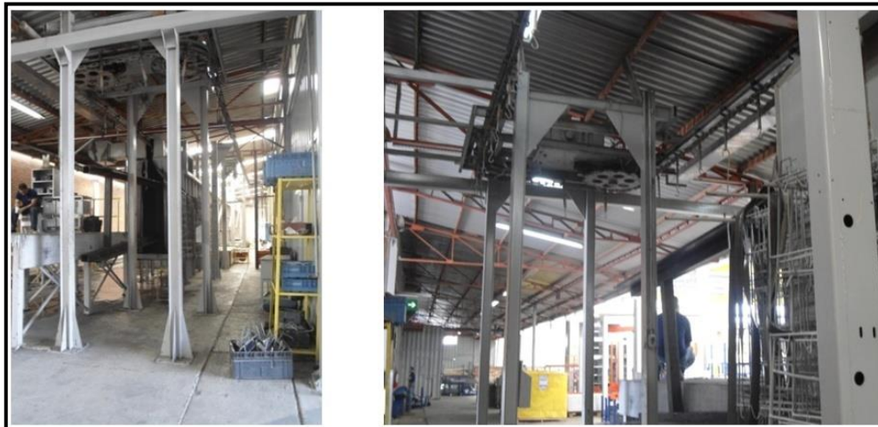
Figura 48 – Colunas laterais que dificultam o acesso à plataforma
