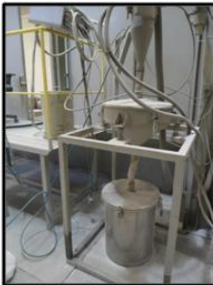
Figura 51 – Equipamento de reservatório antigo.
