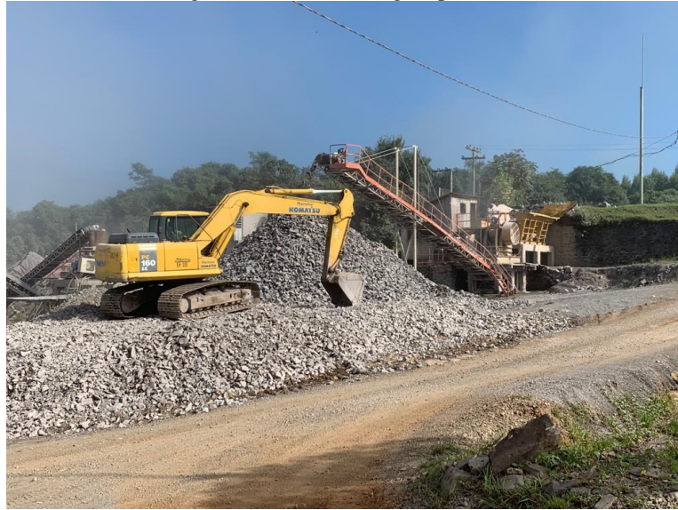
Figura 4 - Foto da britagem primária.
