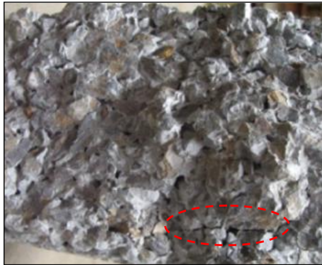
Figura 8 - Fratura de uma amostra de concreto permeável predominantemente na zona de interface pasta/agregado (LIAN e ZHUGE, 2010).
