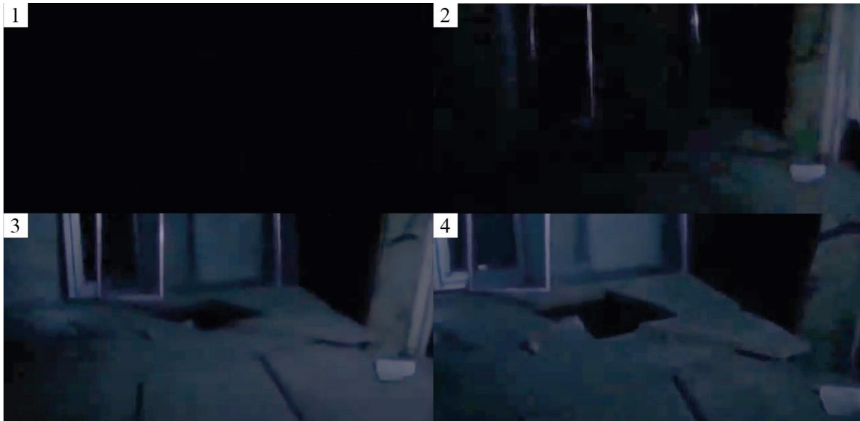
Figura 14 – Buraco no porão
