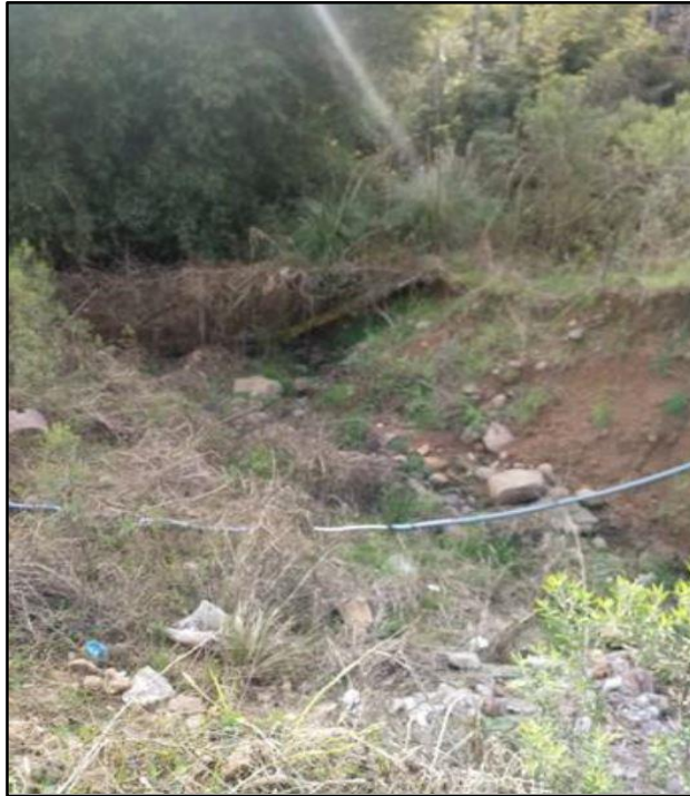
Figura 31 - Voçoroca na área norte do empreendimento
