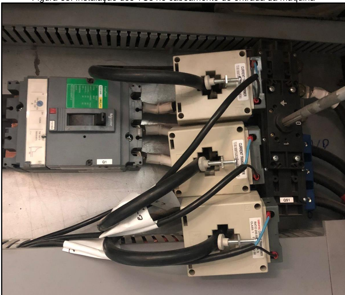
Figura 63: Instalação dos TCs no cabeamento de entrada da máquina
