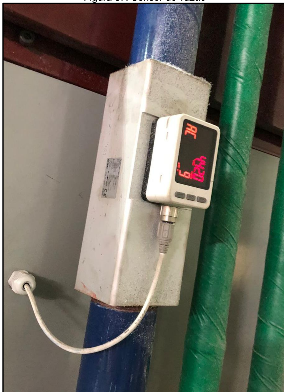
Figura 67: Sensor de vazão
